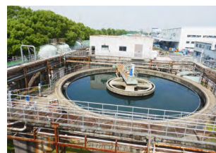
総合排水処理施設 (岡崎製作所)
