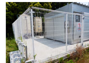
地下水膜ろ過設備（岡崎製作所）
