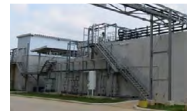
工業用水排水処理場
