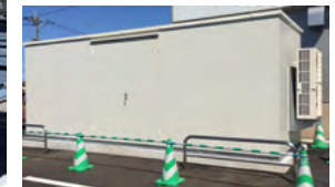
蓄電池ユニット
