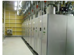
小型貫流ボイラー
