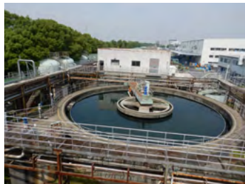
総合排水処理施設(岡崎製作所)
