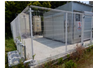
地下水膜ろ過設備(岡崎製作所)
