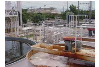
総合排水処理施設
