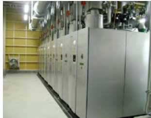
小型貫流ボイラー
