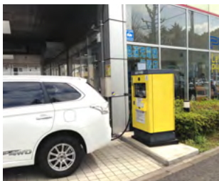
販売会社に設置した急速充電器
