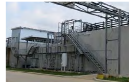
工業用水/排水処理プラント （左奥：工業用水処理プラント、右：排水処理プラント）
