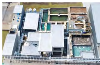
排水リサイクルプラント (MMTh)
