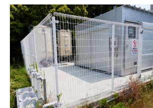
地下水膜ろ過設備(岡崎製作所)
