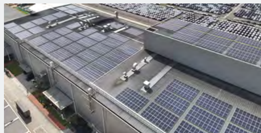
MMKIの塗装工場太陽光発電設備
